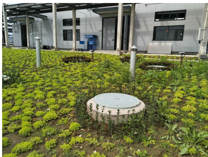
图 4.1-1 地埋式污水处理池
