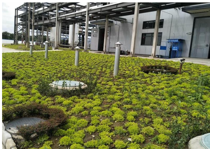
图 4.2-3 地下事故应急池及初期雨水池
